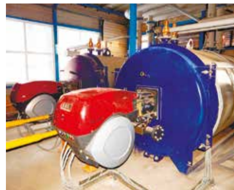
Блочно-модульная котельная ООО «ВМТЗ» с КПД 93% оснащена автоматикой для регулирования теплоснабжения в зависимости от температуры наружного воздуха
